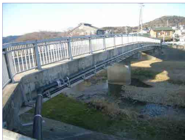
水管橋（アラミド外装PE管 φ150）
