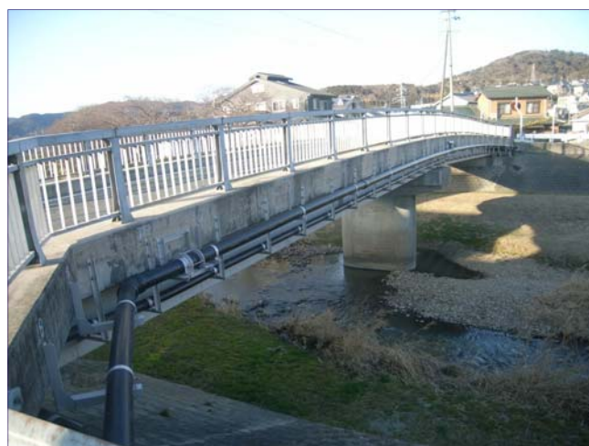
水管橋（アラミド外装PE管 φ150）
