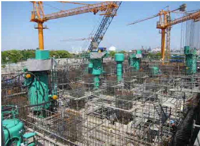
浄化センター
