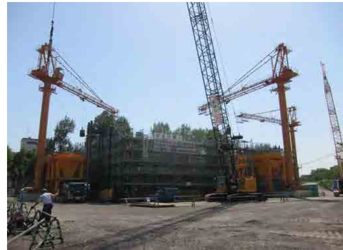
浄化センター2
